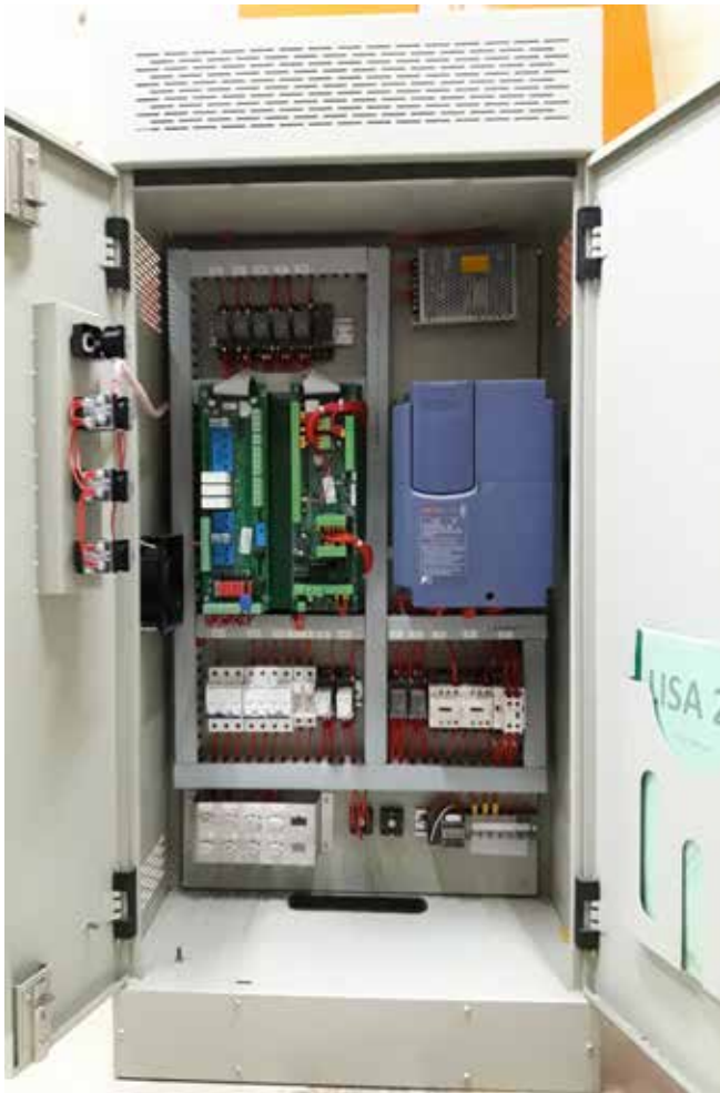
Tủ điều khiển (LiSA20), có phòng máy, 630kg - 1.6m/s - 8 stops • Control cabinet, machine room type
