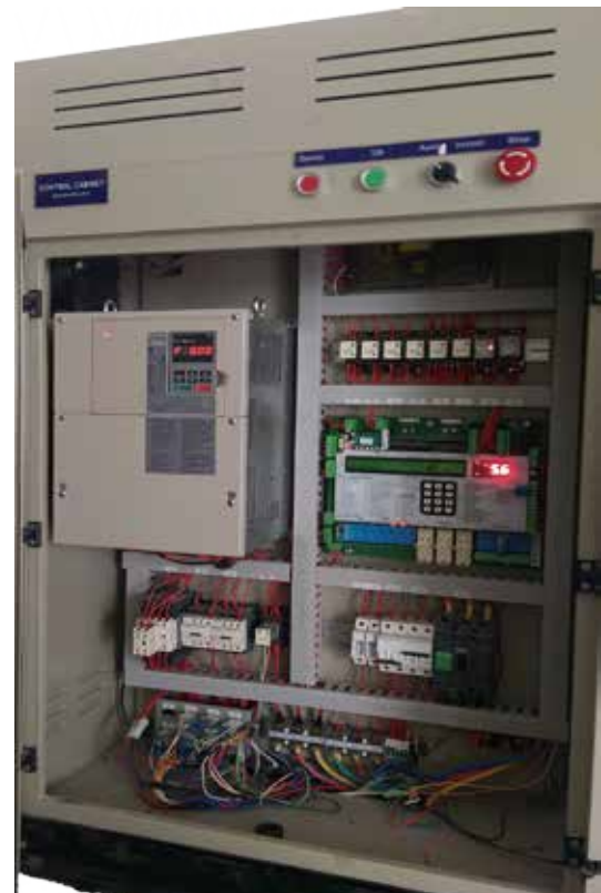
Tủ điều khiển (LiSA10), có phòng máy, 1350kg - 1.75m/s - 14 stops Control cabinet, machine room type
