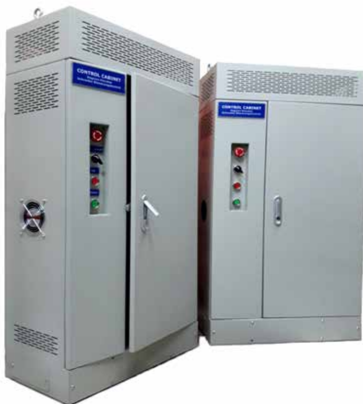
Tủ điều khiển chính • Main control cabinet (MCC)
