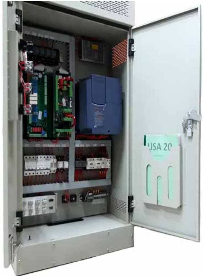
Tủ điều khiển (LiSA20), có phòng máy, 800kg - 1.6m/s - 12 stops • Control cabinet, machine room type
