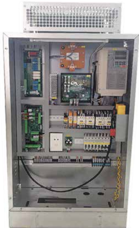
Tủ điều khiển (LiSA20), có phòng máy, 630kg - 1.5m/s - 14 stops Control cabinet, machine room type
