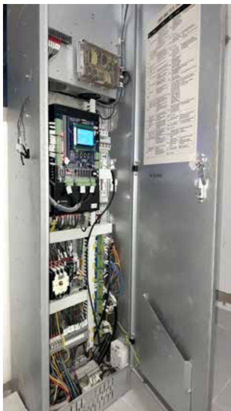
Tủ điều khiển Schneider nhập khẩu từ Thái Lan • Imported MCC from Thailand
